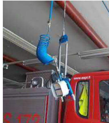
Ripustettu pistorasiakotelo kalustohallissa
