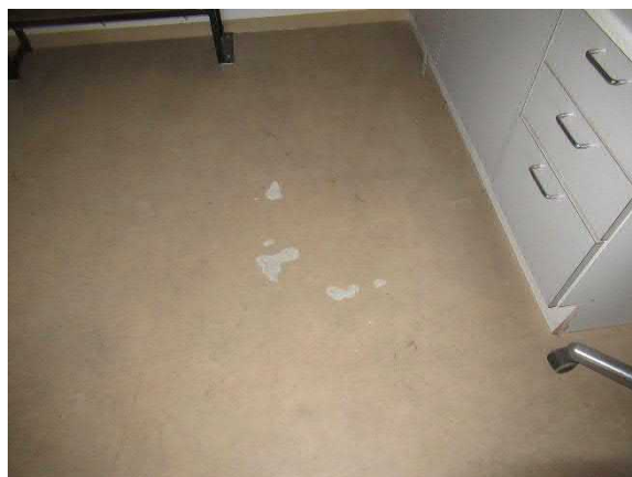
Lattiapintamateriaaleissa kulumaa ja vaurioita
