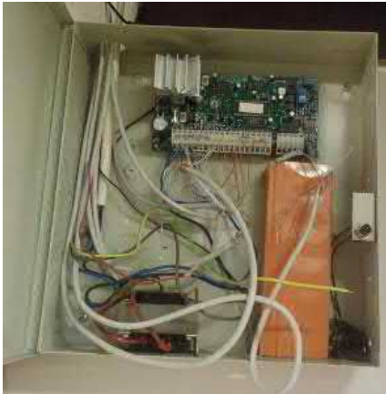
Laitteiston keskusyksikkö IV-konehuoneessa
