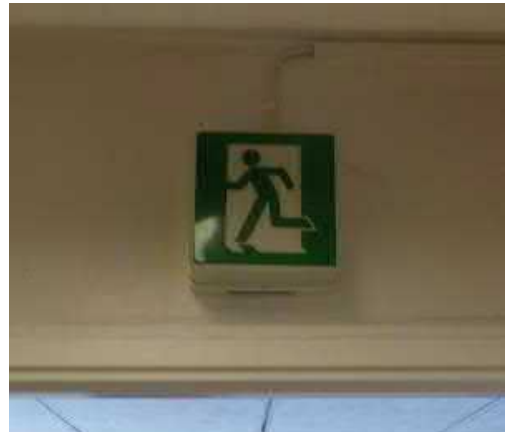
Poistumisvalaisin oven päällä
