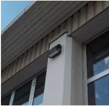
Seinävalaisin nosto-ovien välissä
