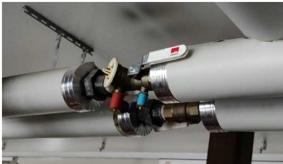
Alkuperäiset linjasäätöventtiilit ovat saavuttaneet teknisen käyttöikänsä.
