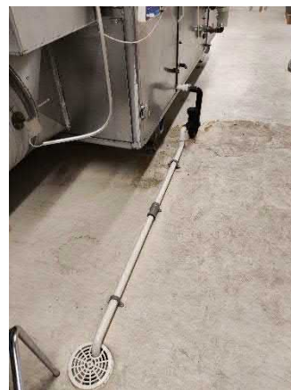
IV-konehuoneen lattiakaivo ja vuotojälkiä.
