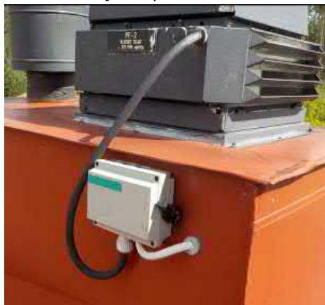
IV-koneen läpivienti vesikatolla
