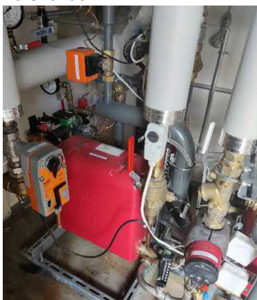
Kaukolämpöpaketti, hyvässä ja siistissä kunnossa.
