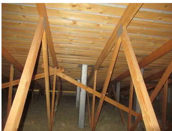
Valumajälkiä letkutornin läpivientien kohdilla
