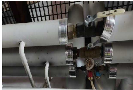
Alkuperäiset vesijohtoverkoston venttiilit.
