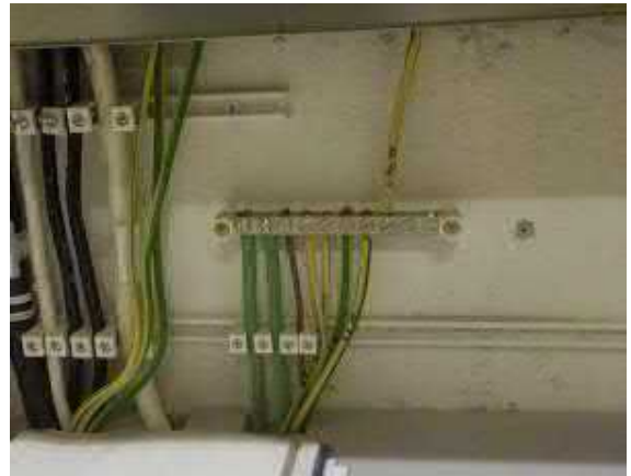
Maadoituskisko pääkeskuksen yhteydessä
