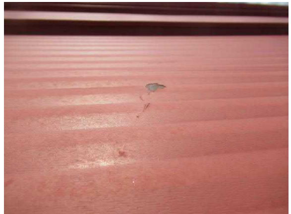
Maalipinnoite on paikoin kulunut, näissä kohti havaittavissa alkavia korroosioaurioita
