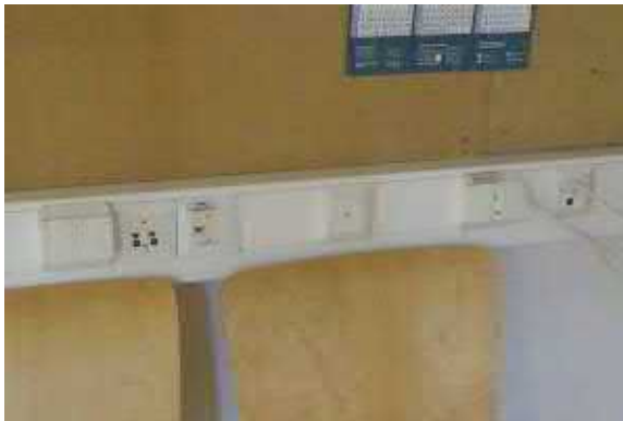
Johtokanavaa rasiointineen toimistossa
