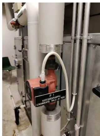
Alkuperäinen IV-kiertopumppu, tekninen käyttöikä ylittynyt.
