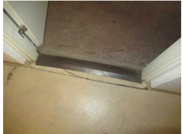
Toimistopuolen alapohjan halkeilua
