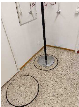
Väestönsuojan sulkuventtiilit kansien alla.
