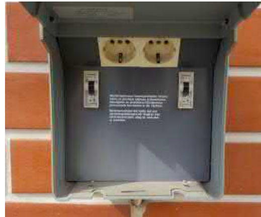
Ajoneuvon lämmityskotelo ulkoseinällä
