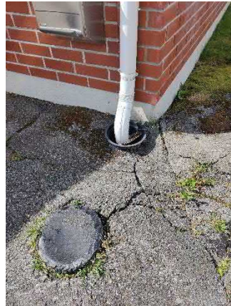
Rännikaivojen läheisyydessä halkeilua.
