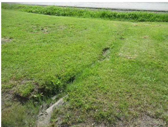
Piha-alueen etelälaidassa sade-/hulevesien ohjauskouru tontin rajalla olevaan ojaan
