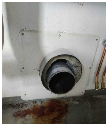
Tiivistämätön savupiipun hormi
