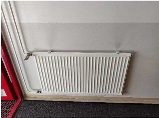
Alkuperäinen patteri ja venttiilit
