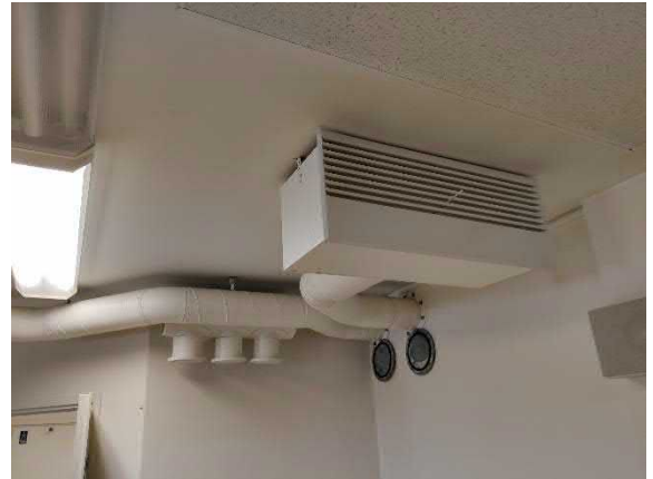
Tuloilmahajottaja ja poistoventtiilit
