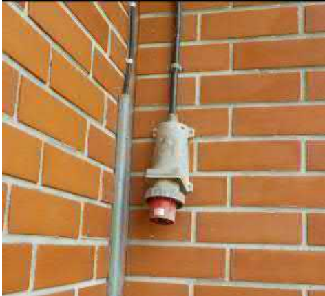
Varavoiman kytkentäpiste rakennuksen takana
